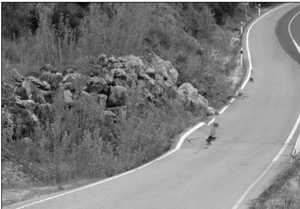
Figura 15.14. Fallo por hundimiento en una escollera. Fotografía: autores.
