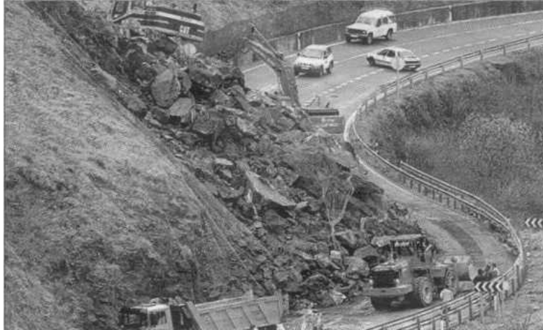
Figura 9.4. Rotura plana con deslizamiento de un volumen importante de roca en una carretera de Cantabria, lo que obligo al cierre de la vía y remodelación del talud. Fotografía de prensa.
