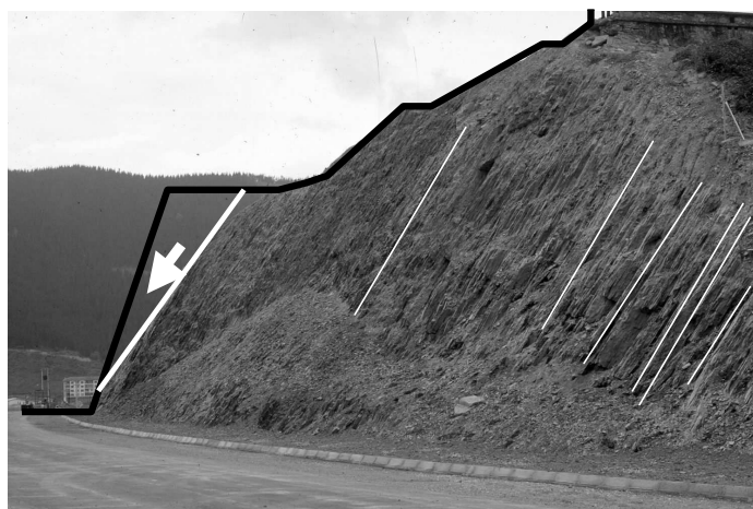
Figura 8.8. Talud en un macizo rocoso de tipo flysch con discontinuidades bastante inclinadas. Estas discontinuidades no afectan la estabilidad el talud cuando sus rumbos no coinciden (derecha), pero han dado lugar a una inestabilidad para el caso de coincidencia de rumbo (izquierda). Foto: autores.
