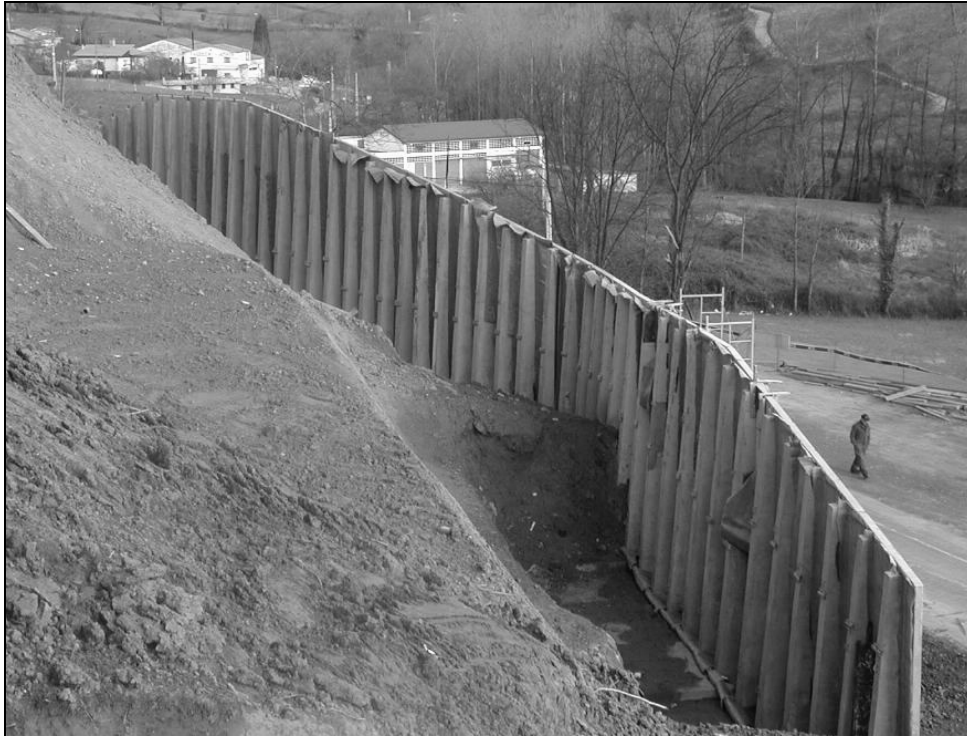
Figura 15.6. Muro prefabricado antes de colocar el relleno en el trasdós. Fotografía: autores.
