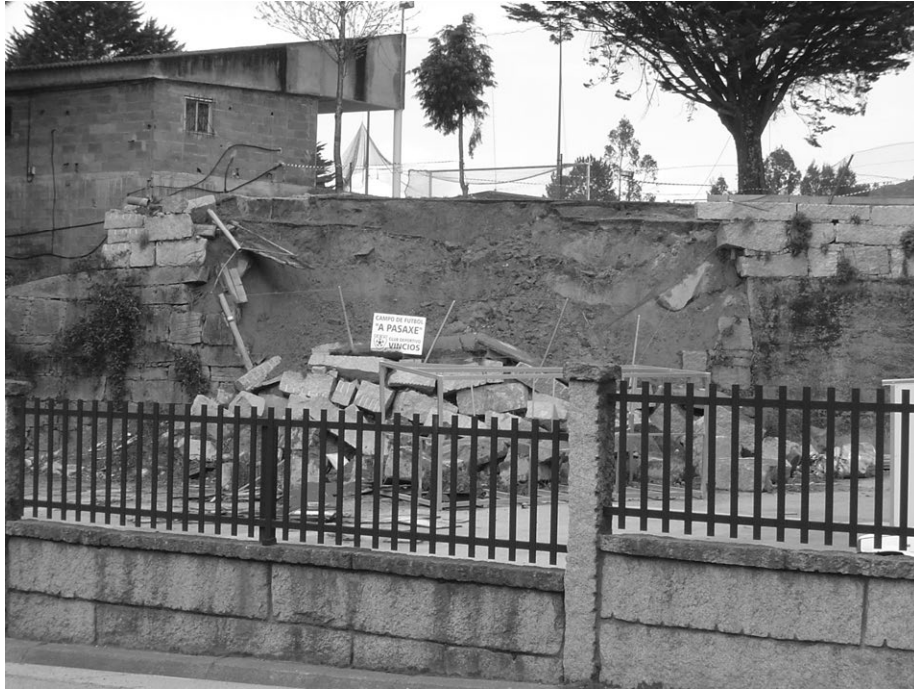
Figura 15.10. Muro de mampostería con granito rosa Porriño de unos 8 metros de altura, tras sufrir un fenómeno de inestabilidad por vuelco tras una fuerte precipitación. Fotografía: autores.
