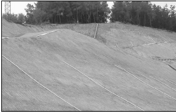
a) con tubos bajantes
