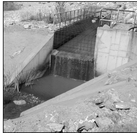
b) Caudal drenado y balsa de decantación
